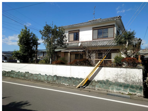
水道管等の劣化あり
